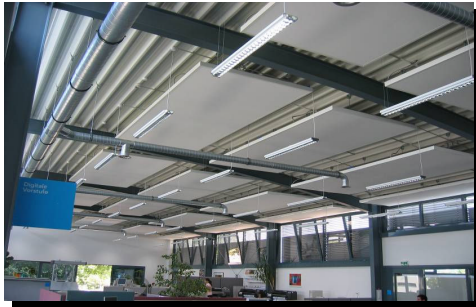
Frei hängende Kühldecken-Segel
